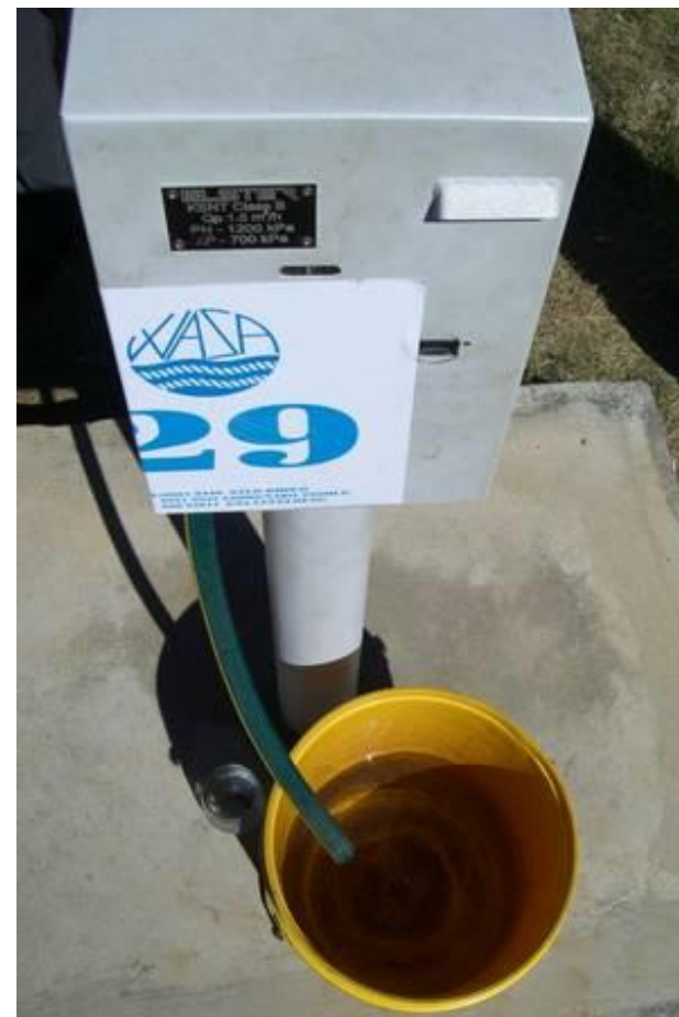
Un medidor de agua en Lesotho. Para obtener agua de este tipo de medidores de agua prepagada, hay que comprar una llave y cargarla con crédito para el agua.
